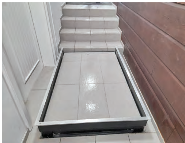
Winda schodowa wyłaniająca się z podłogi...
